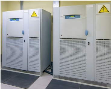
UPS电源系统
